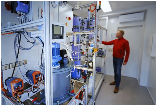
Abb. 1 Versuchscontainer im Gemeinschaftklärlwerk Bitterfeld-Wolfen. Hier werden neue Wassertechnologien praxisnah erprobt, um Energie und wertvolle Rohstoffe aus chemischen Prozesswässern zurückzugewinnen.
